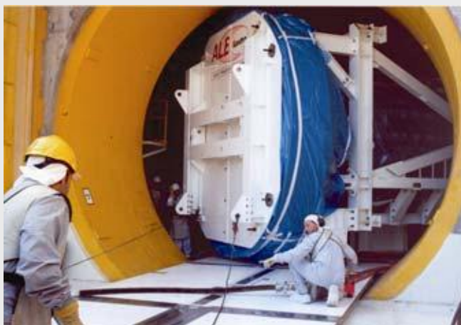
Schwere, horizontale Bewegungen werden in kleinen Räumen ohne Schwierigkeiten ausgeführt. Reaktordeckel, 75 Tonnen.
